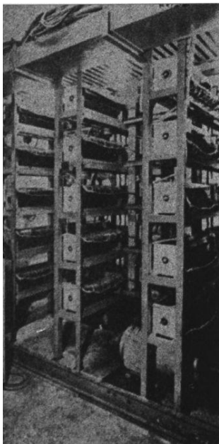
Kabeláž počítače SAPO
